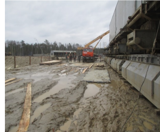
СООРУЖЕНИЕ ТЕХНОЛОГИЧЕСКОЙ ПЛОЩАДКИ ИЗ ПЛИТ ДЛЯ ПОДВОЗА, РАЗМЕЩЕНИЯ УЗЛОВ И ДЕТАЛЕЙ БУРОВОЙ УСТАНОВКИ БУК200 Э-БМ-ЦК.
